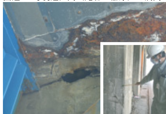
老朽化した構造物（橋梁・洞門）
