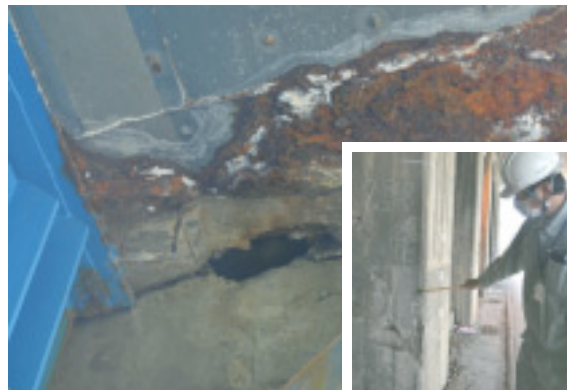
老朽化した構造物（橋梁・洞門）
