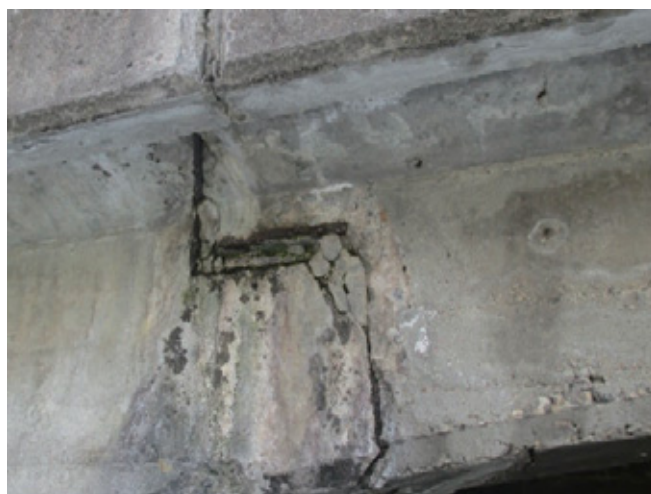
八田橋損傷状況
