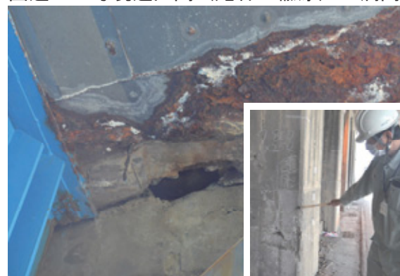
老朽化した構造物（橋梁・洞門）
