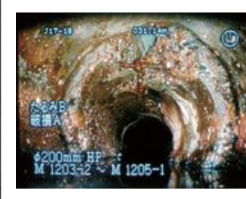
調査の結果、改築の必要ある下水道
