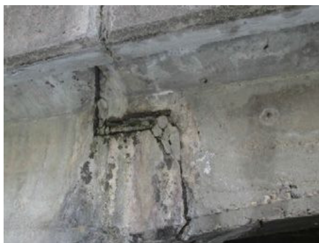
八田橋損傷状況
