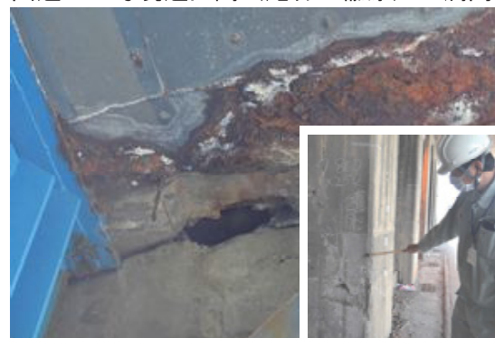
老朽化した構造物（橋梁・洞門）
