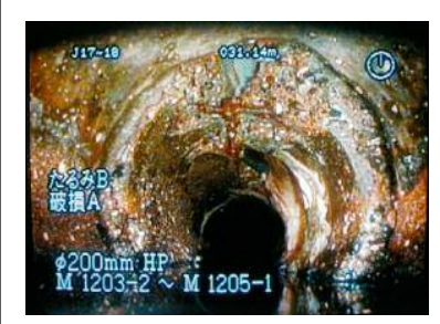
調査の結果、改築の必要ある下水道管
