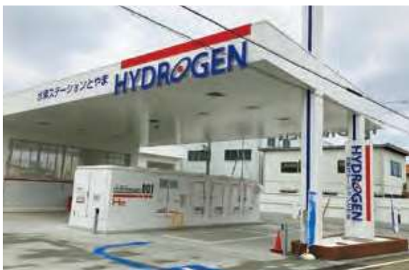
水素ステーション
