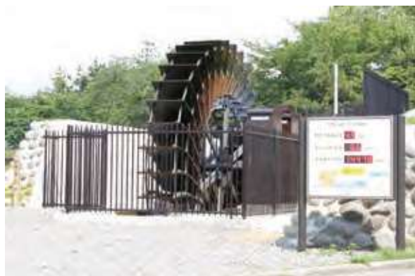
小水力発電施設
