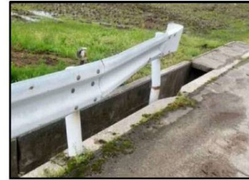
＜その他の道路損傷＞ （ガードレールの破損）
