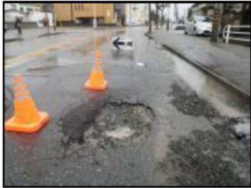
＜道路はく離の様子＞ （舗装のはがれ）
