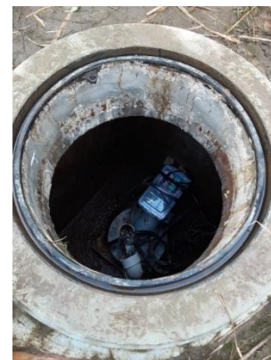
マンホール(外)
