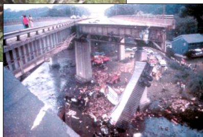
落橋した橋の事例（富山市以外の自治体での例）
