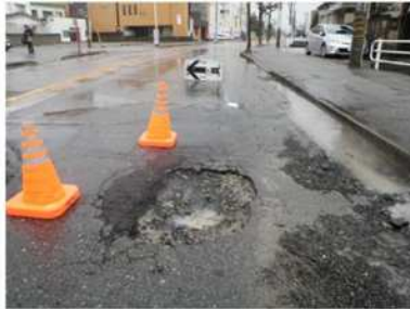
<道路はく離(舗装のはがれ)の様子>
