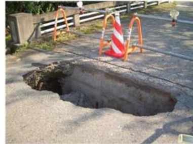
<道路陥没の様子>
