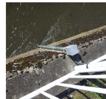
水位センサーの設置状況
