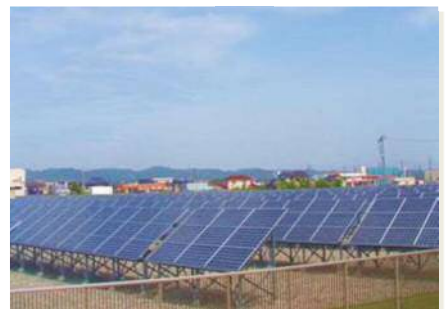
▲富山太陽光発電所(H23.4稼動)
