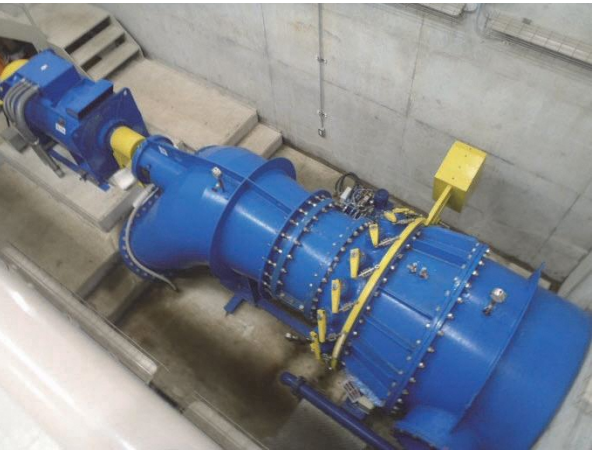
東町・東新町公民館小水力発電所
