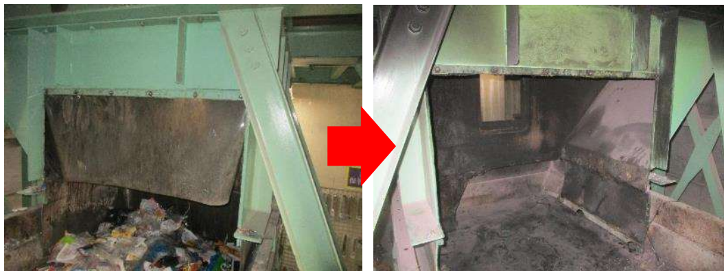
塩ビシート、ゴム部分が熱により溶けた状態
