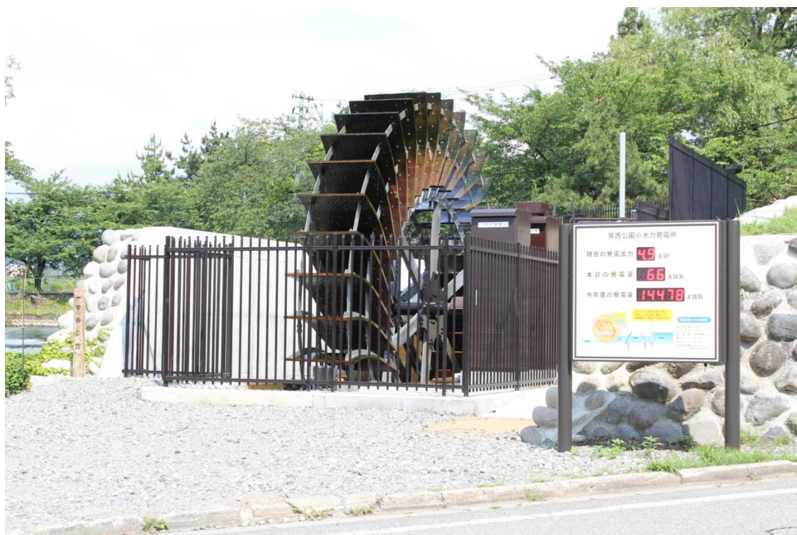
小水力発電施設（上滝地内）
