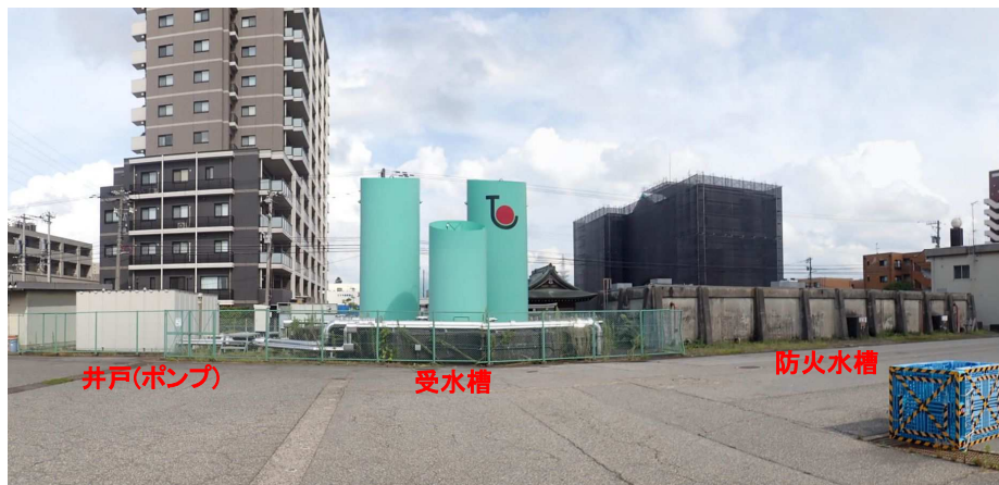
写真 4.3.3 井戸、受水槽、防火水槽
