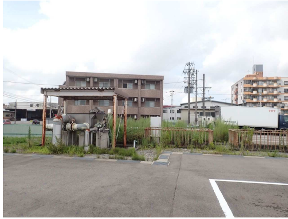
写真 4.3.2 排水処理施設
