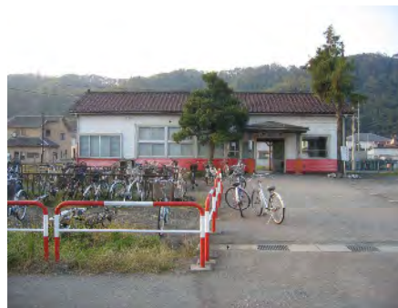
図 1-2-6 老朽化が見られる駅舎
