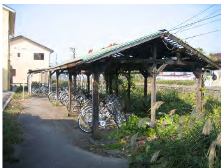
図 1-2-7 老朽化が見られる駐輪場
