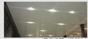
馬車道駅(横浜市) 天井: 吸音機能を持たせたアルミ材
