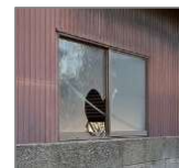
窓が割れた管理不全空家
