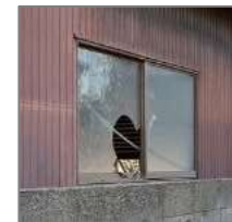
窓が割れた管理不全空家
