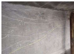
ひび割れの進展
