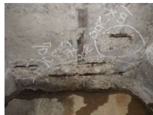
深刻な断面欠損
