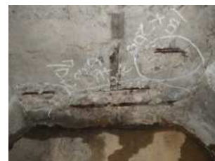
深刻な断面欠損
