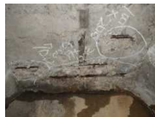
深刻な断面欠損
