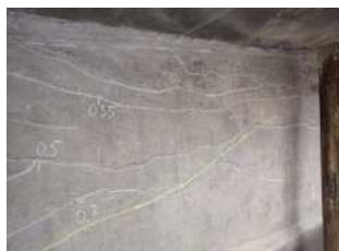
ひび割れの進展
