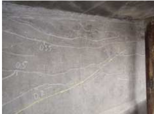
ひび割れの進展
