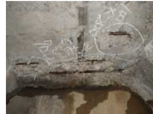
深刻な断面欠損
