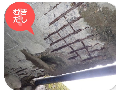
コンクリート床版の鉄筋露出
