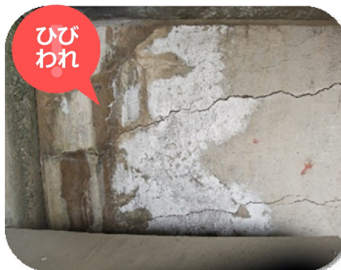
コンクリート桁のひび割れ
