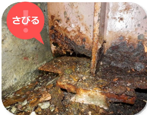
鋼部材の腐食・孔食
