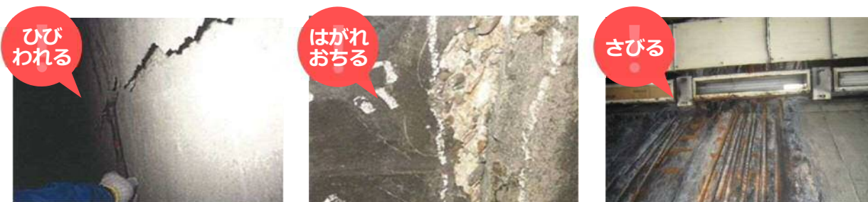
老朽化に伴う一般的なトンネルの変状例
