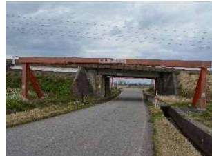
水橋新保 1 号門型標識 高さ/3.8m 幅員 7.0m 所在地/水橋新保地域
