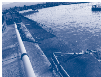
破損した水橋漁港の転落防止柵
