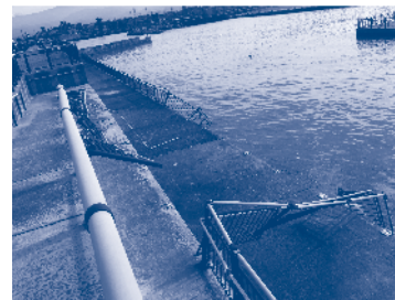
破損した水橋漁港の転落防止柵
