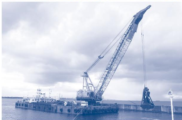
台風19号により被災した四方漁港の航路浚渫（しゅんせつ）工事の様子
