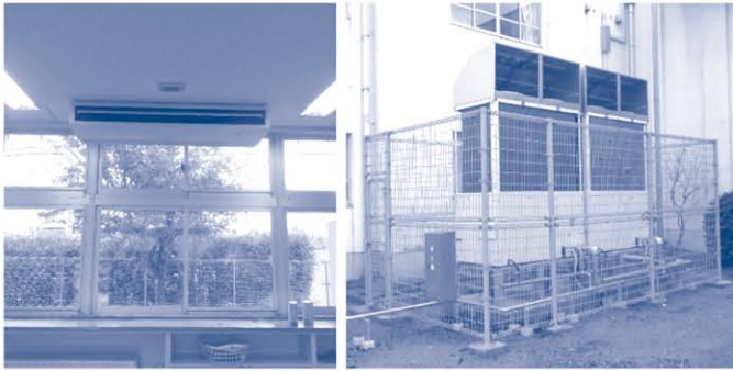
学校に新しく設置されたエアコン
