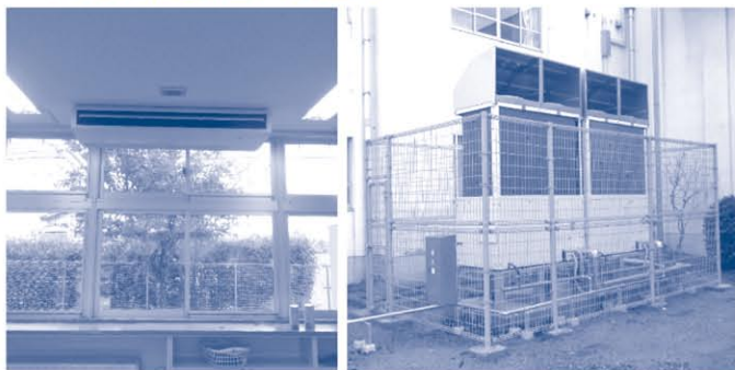
学校に新しく設置されたエアコン
