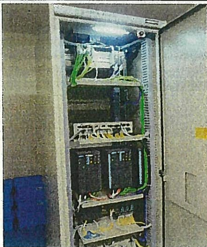
写真 流杉浄水場コントローラ盤
