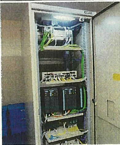
写真 流杉浄水場コントローラ盤
