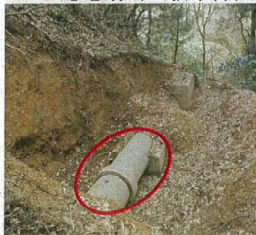
ヒューム管φ400漏水
