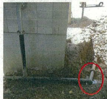
配水管φ100漏水
