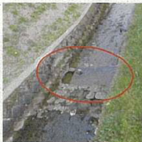
石張水路底損傷
