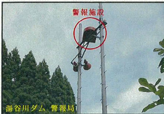
湯谷川ダム 警報局
