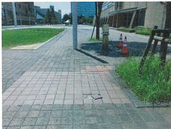
タイルの破損状況
