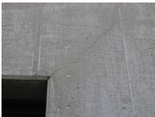
図 コンクリートのひび割れ
