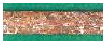
図 鉄筋の腐食
