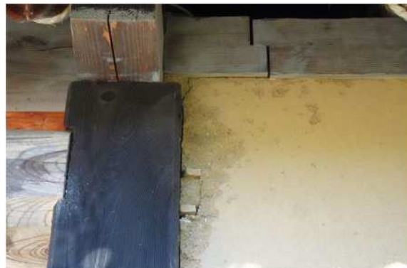
長屋門軒樋継手の開き
