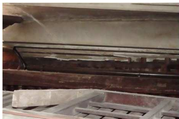
主屋壁亀裂・剥落
