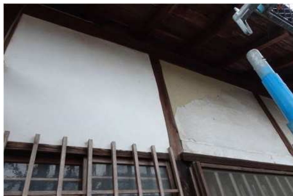
主屋北側面内法上小壁の剥離と剝落
