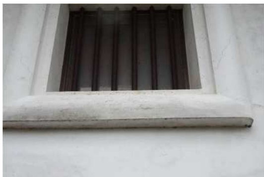
米蔵壁亀裂・剥落
