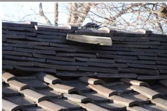
長屋門屋根棟積瓦のズレ
