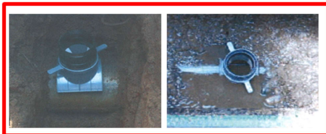
締め込み不良 ツメのセット不良
