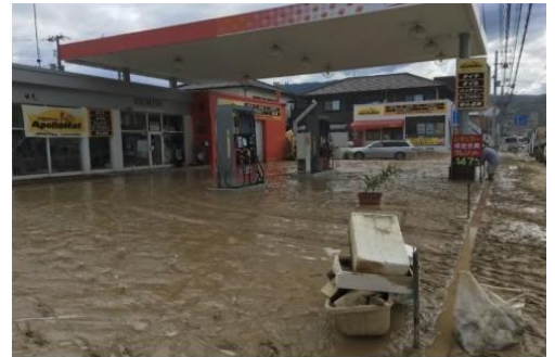
☆写真（消防庁HP引用） 〈豪雨による給油取扱所への土砂流入〉
