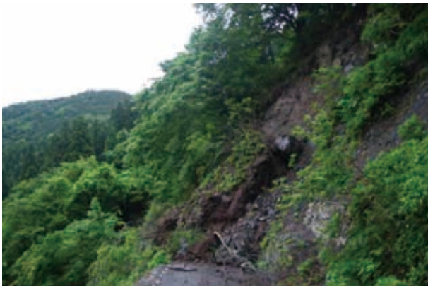
上笹原小井波線の土砂崩落(H24)
