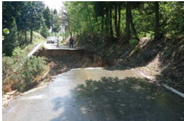
吉谷牛滑線の道路崩壊(H27)
