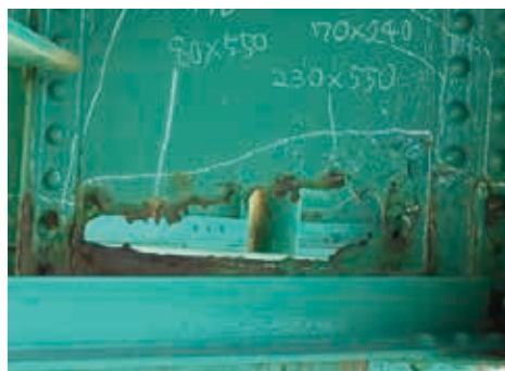
横桁ウェブで腐食が進展 耐荷性能が低下
