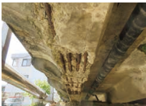
主桁下面で鉄筋腐食が進展 耐荷性能が低下
