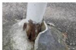
警戒標識の支柱の腐食
