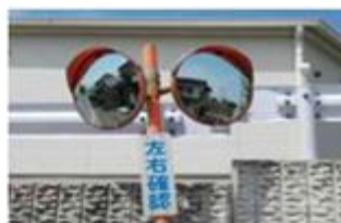
カーブミラーの支柱の傾き
