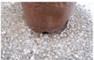
カーブミラー(照明)柱の腐食
