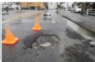
はく離の様子
