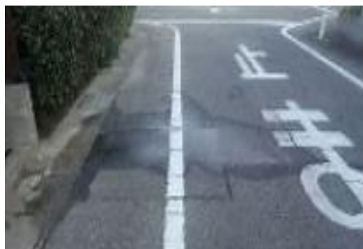
道路漏水の様子
