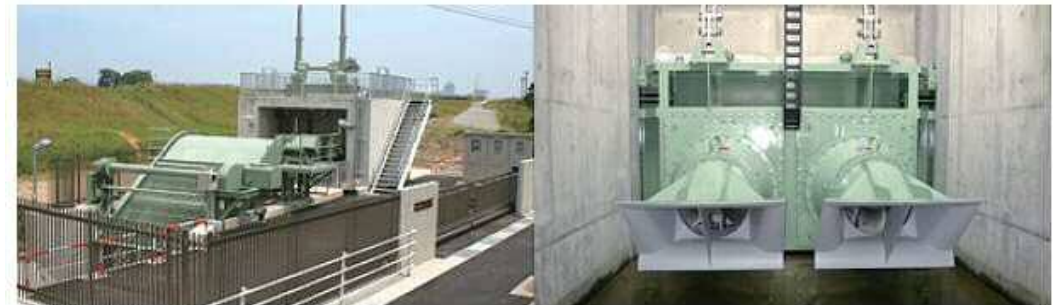
神明ポンプゲート場
