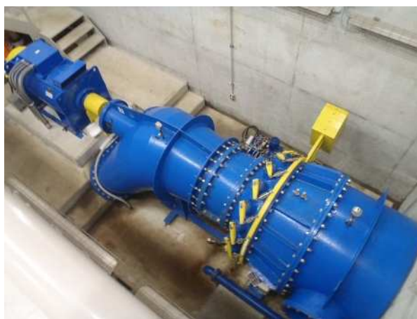
東町・東新町公民館小水力発電所
