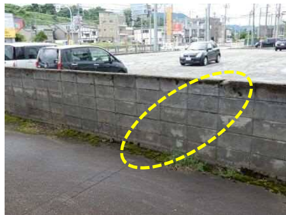
ひび割れ 2. 6 m
