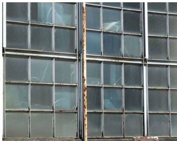
鉄枠の腐食とガラスのひび
